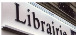
Rampe lumineuse cachée derrière un capot sous la corniche
